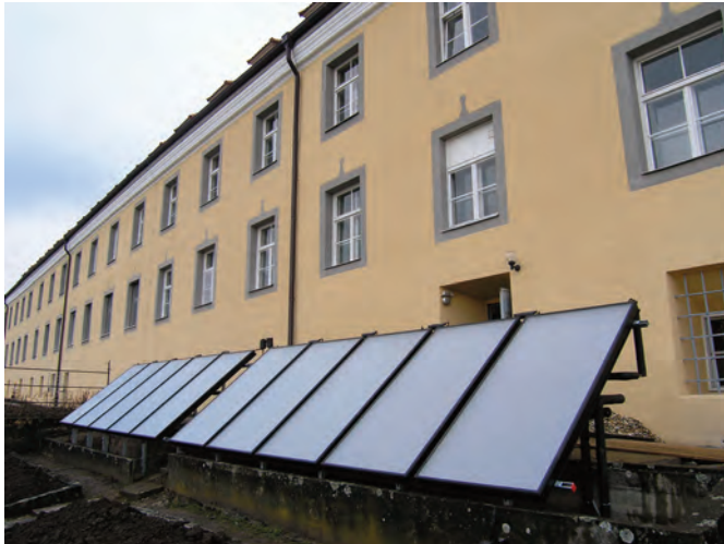
Sonnenkollektoren für Brauchwassererwärmung an der Südseite des Klosters.
